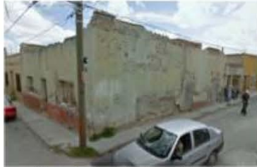
Ejemplo de vivienda en deterioro.
