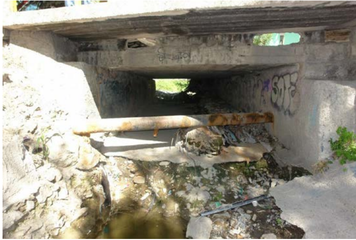
Figura 191. Errores en el diseño de la infraestructura que obstruyen los arroyos.
