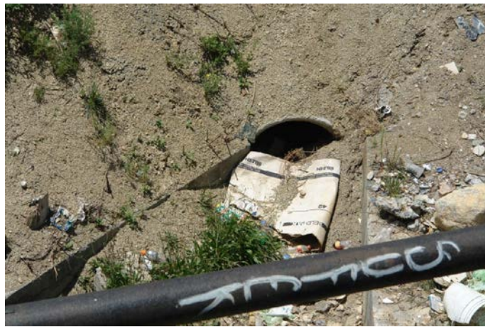
Figura 192. Obstrucciones en la infraestructura hidráulica construida.
