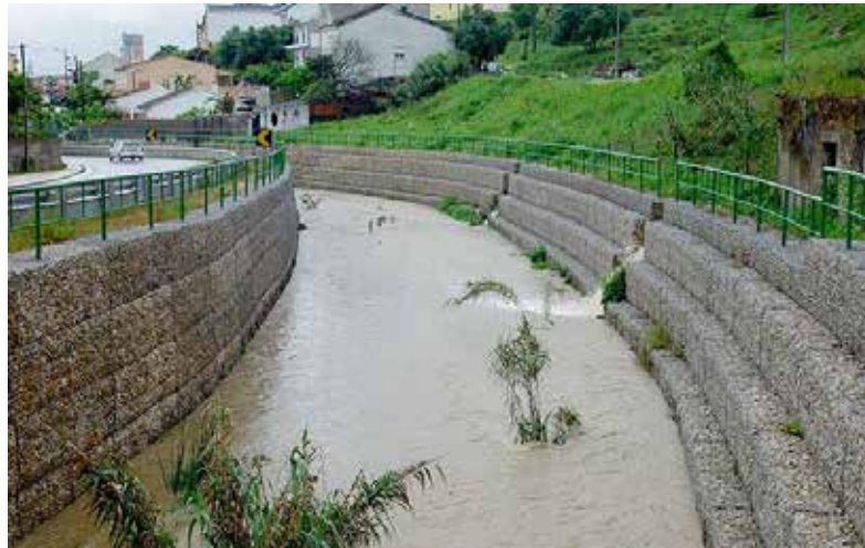
Figura 369. Ejemplo de construcción de gaviones para protección del cauce. (tomada de: http://conceptodefinicion.de/gavion/ ).
