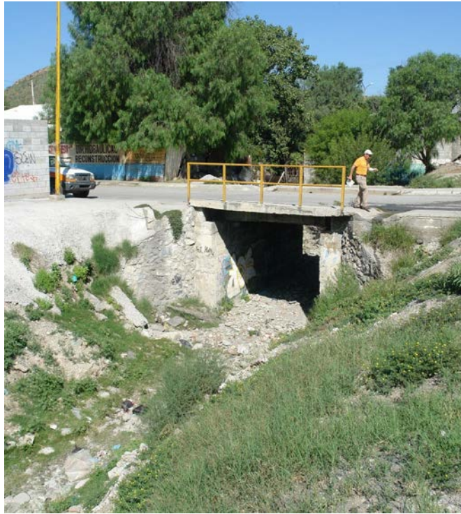
Figura 189. Ejemplo de infraestructura obstruyendo el arroyo.
